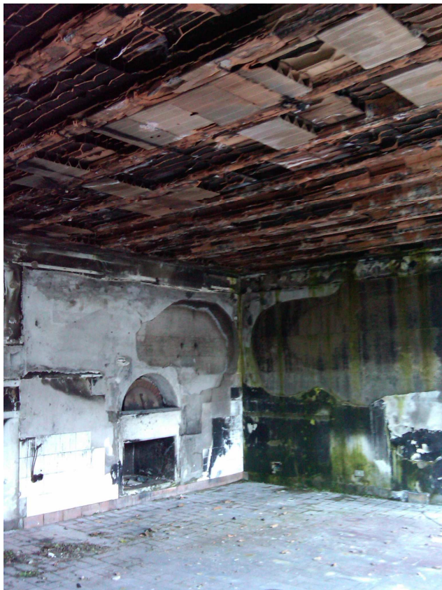
Untersicht abgebrannte Decke – vista del solaio bruciato
