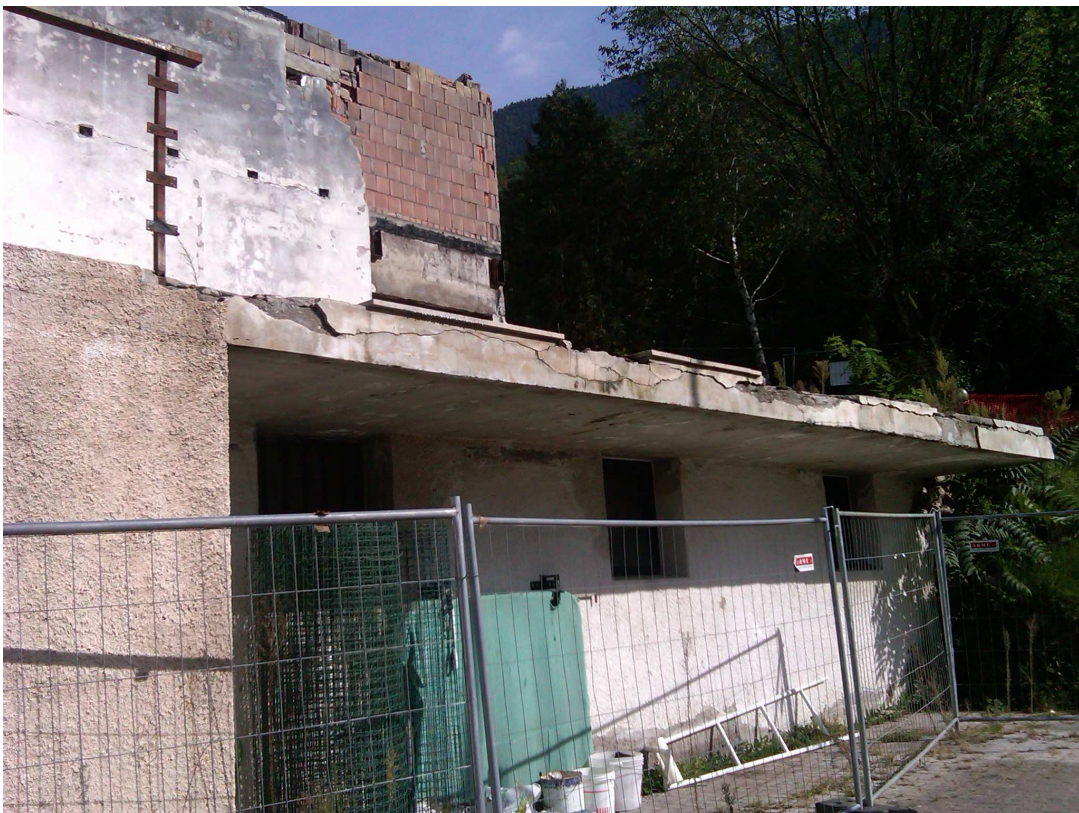
Ansicht Bestand von Südwest unteres Niveau 2 – Prospetto edificio esistente da sudovest piano inferiore 2
