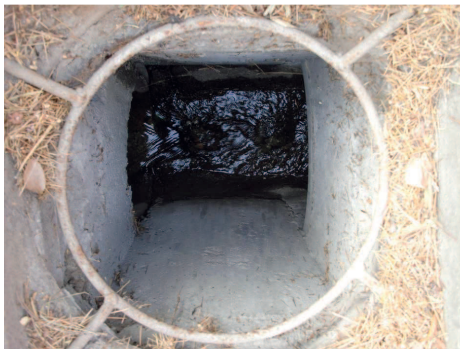
POZZETTO ACQUE BIANCHE – VIA VIRGILIO WEISSWASSERSCHACHT – VERGILSTRASSE
