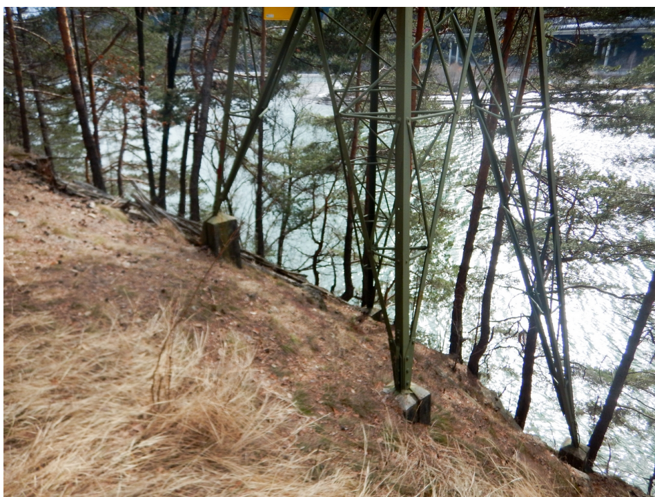
(b) Particolare traliccio linea elettrica sul versante in sinistra lago
