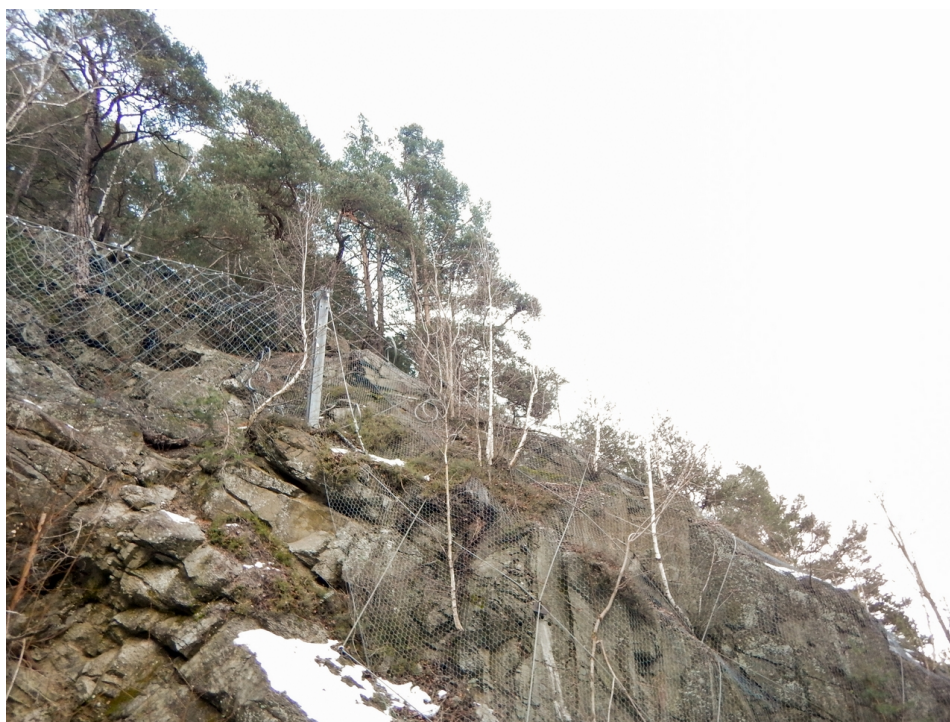
(b) Paramassi e reti di trattenuta sulla parete sovrastante l'impluvio del torrente K6
