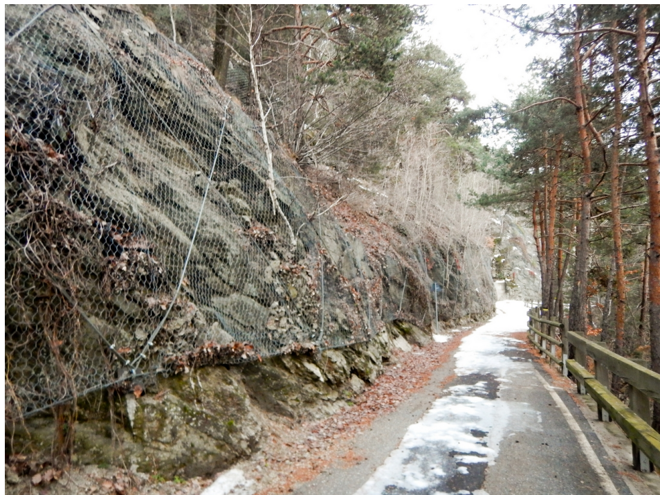
(a) Reti di trattenuta sulla parete sovrastante la pista ciclabile verso il torrente K7
