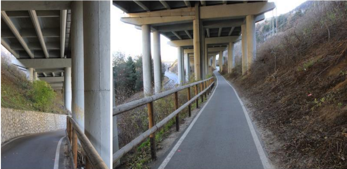
Foto 36: Il tratto di pista ciclabile sottostante il viadotto dell'A22 che attraversa il detrito di versante rimaneggiato.
