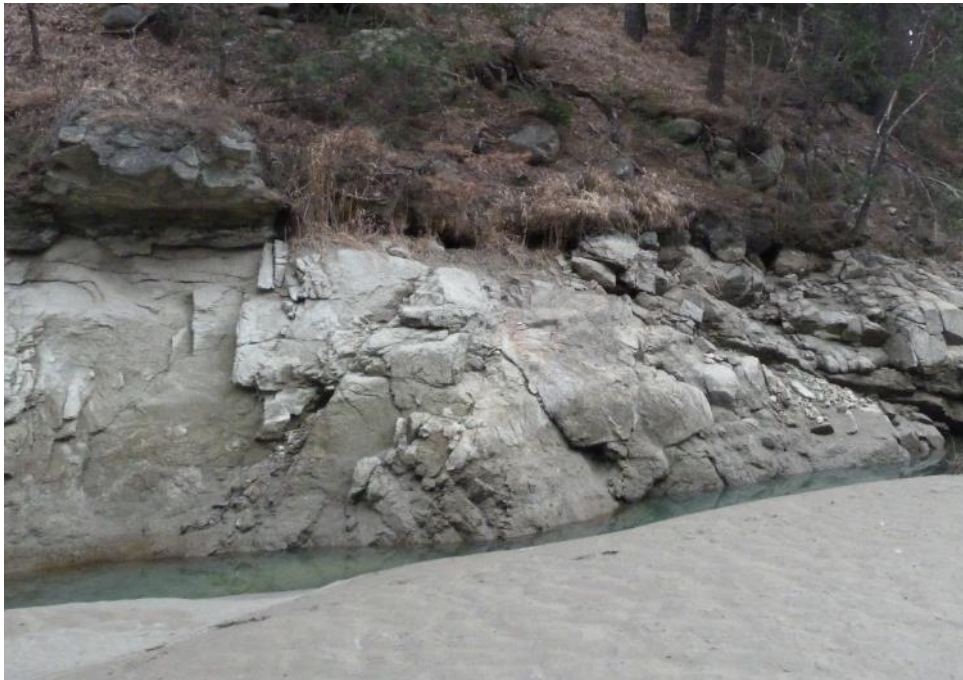
Foto 8: Un affioramento di Granito di Bressanone sulla sponda sinistra idrografica del lago. Si notino la fratturazione e l'alterazione.
