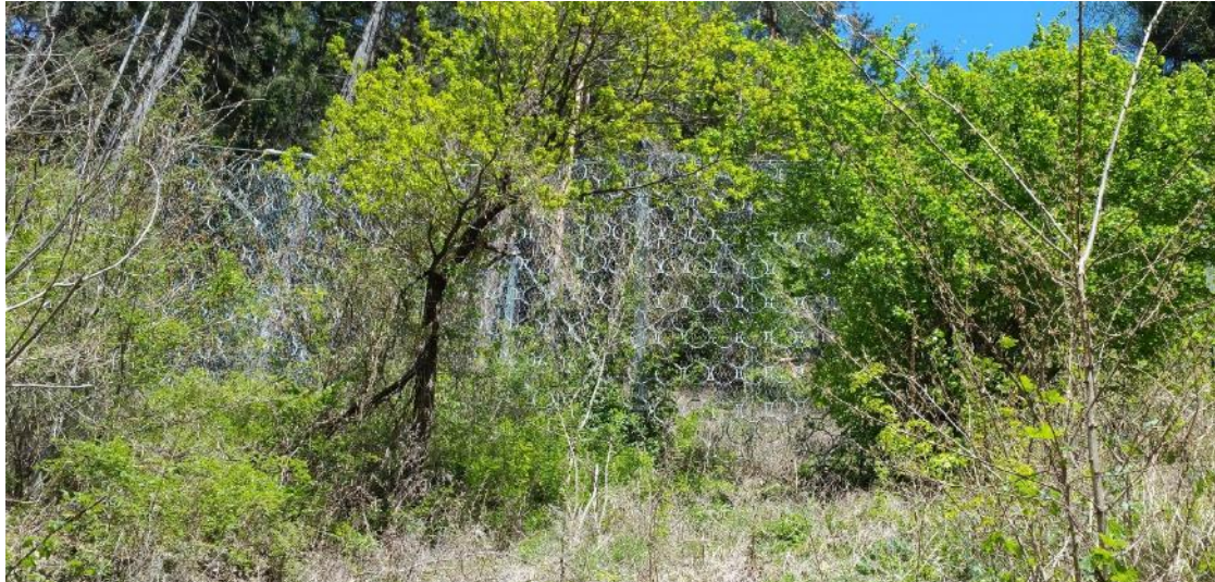
Foto 44: La paramassi a protezione del tratto dell'A22 compreso tra la galleria e l'inizio del viadotto.
