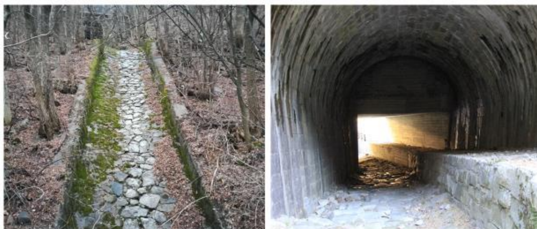
Foto 14: A sinistra: il dreno superficiale del Rio Salceto (in secondo piano il sottopasso alla ferrovia); sulla destra: il sottopasso alla ferrovia del Rio della Chiusa.
