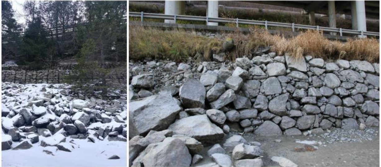
Foto 30: Le gabbionate che sostengono la scarpata in deposito antropico al di sopra della quale corre oggi la SS12 (sulla sinistra) e i ruderi del muro a secco che sosteneva la sede stradale antecedente alla realizzazione dell'invaso che si ritrovano a sud est della penisola (sulla destra).
