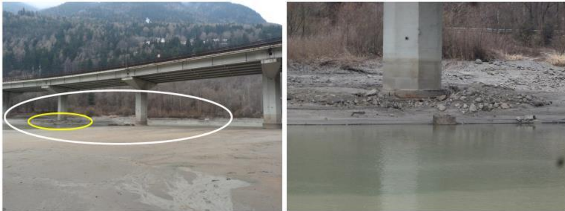
Foto 20: L'area del conoide del Rio Salceto (evidenziata in bianco) e un dettaglio (foto di destra) dei depositi a carico del conoide (evidenziati in giallo nella foto di sinistra), parzialmente ricoperti dai depositi fini attuali.
