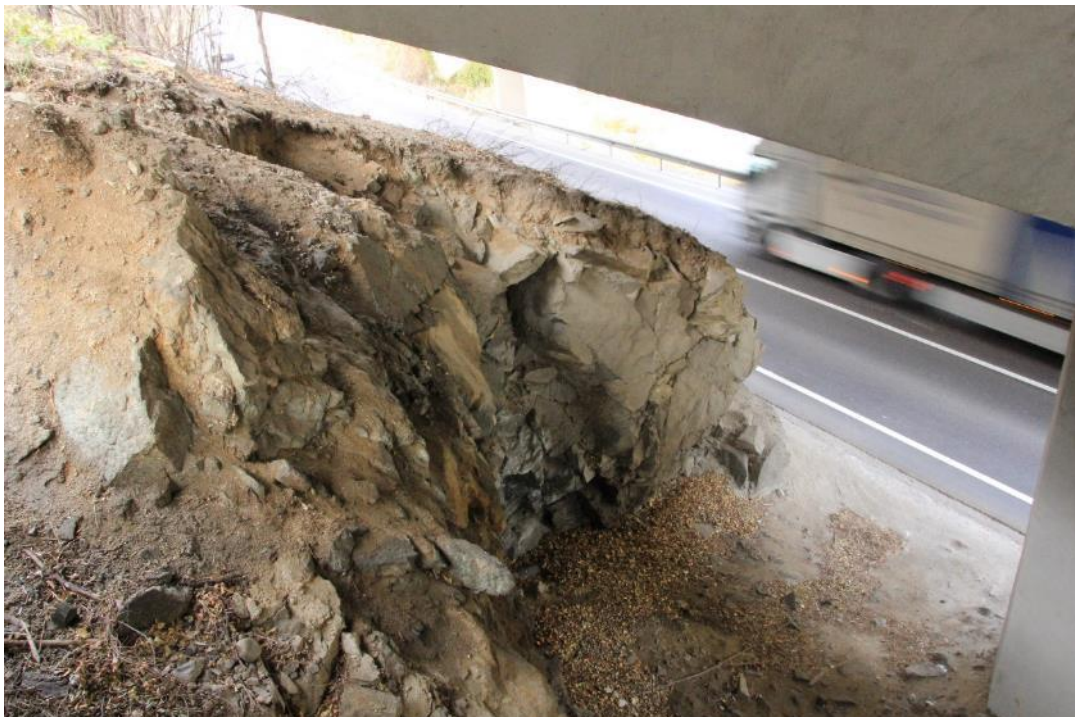
Foto 23: Lo sbancamento del versante realizzato per la fondazione di un pilone del viadotto dell'A22 ha fatto affiorare il substrato roccioso.
