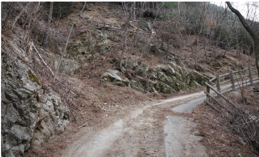
Foto 53: L'area soggetta a crolli e ribaltamenti ( \varnothing < 0,5 m) in corrispondenza dell'attraversamento del rio K.5. Anche qui l'alterazione dell'ammasso appare molto spinta.
